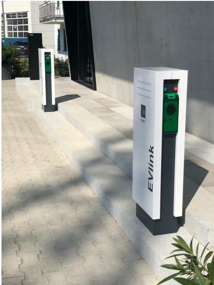
Elektro Maier Standort Rosenheim, hier nutzen mehrere Klienten die Anlage
